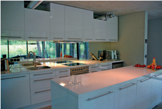
Abb. 2.5: Lichtszenen wie »Abendessen«, »Heimkino« oder »Schlafen« bedeuten die gleichzeitige Steuerung von Beleuchtung, Jalousien, Lüftung und Geräten.
