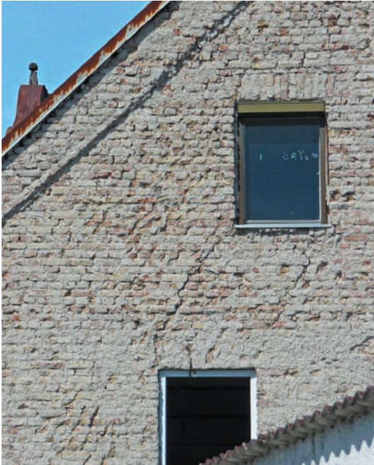
Abb. 1.3: Dieses marode Mauerwerk mit vielen Rissen legt die Frage nahe, ob sich die Statik noch retten lässt und eine Sanierung sich noch lohnt. Vielleicht wäre ein (Teil-)Abriss und Neuaufbau wirtschaftlicher. (Quelle: Erich Keller)
