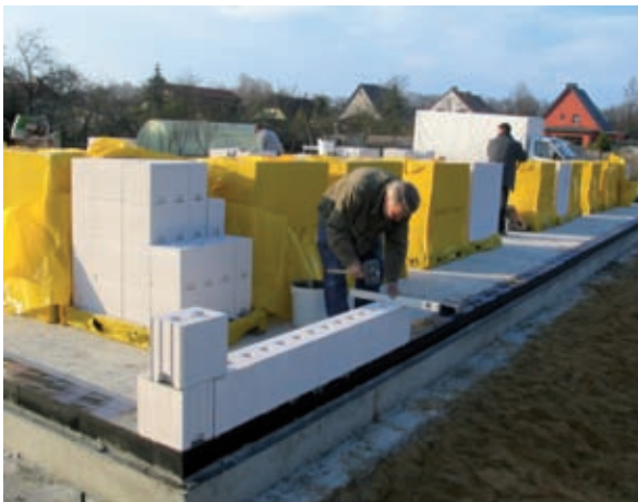
Abb 1.10: Außerdem schließt diese Dämmschicht die geometrische Wärmebrücke in diesem Bereich. (Foto: Deutsche FOAMGLAS)
