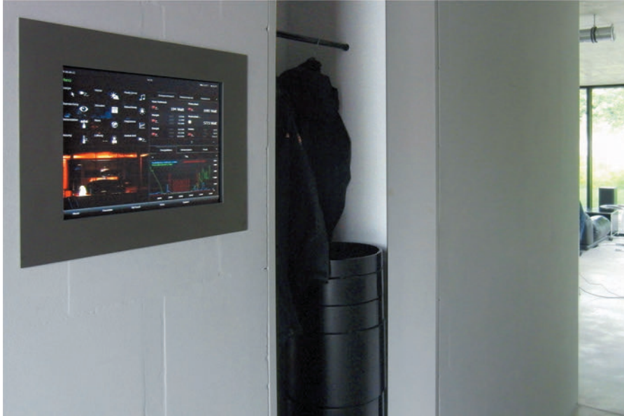
Abb. 2.2: Bedienung und Darstellung über Touchscreen – fortgeschrittene Ausbaustufe einer KNX-Vernetzung.
